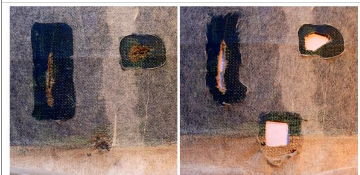
Fig.102 Distintos daños y su posterior limpieza
