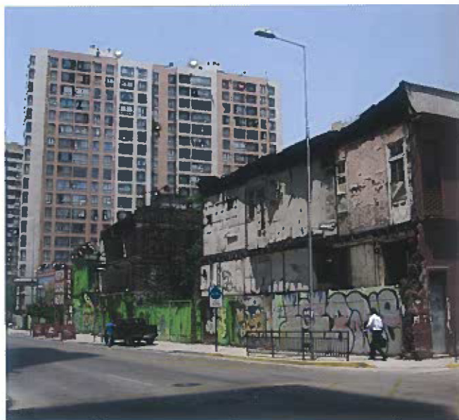
Deterioro de las fachadas en calle Carmen-Santa Victoria, esquina surponiente, año 2012.
