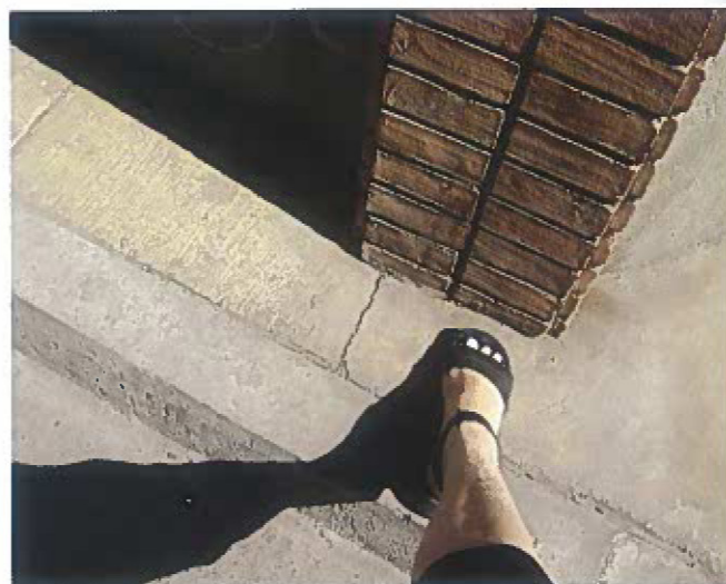
Detalle del ancho de la vereda norte de calle Virreinato esquina Av. Vicuña Mackenna, año 2009.
