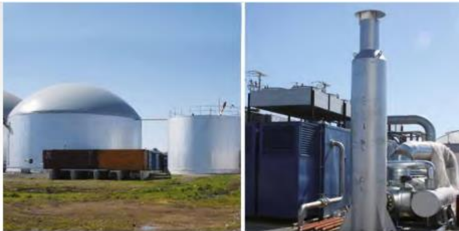
Figura 11: Planta de digestión anaeróbica Los Ángeles - HBS Energía SA.
