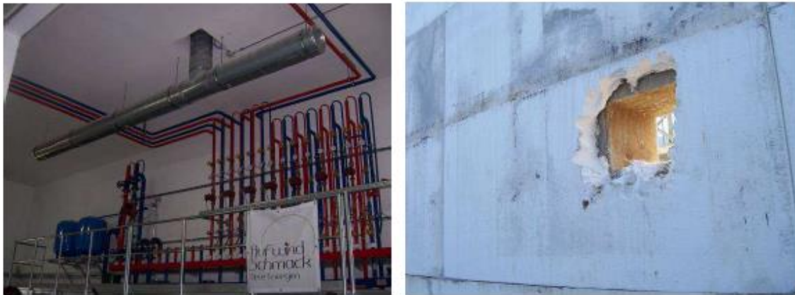
Figura 9: Sistema de calefacción de una planta de biogás (izquierda) y aislación térmica de un digestor de hormigón (derecha)
