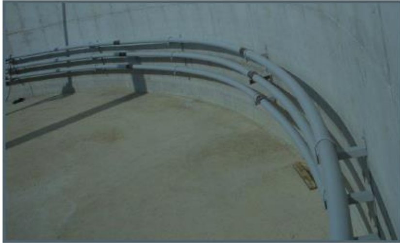
Figura 8: Sistema de calefacción de serpentín interno de un digestor
