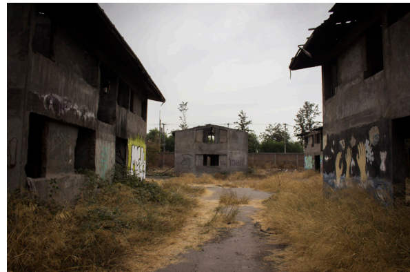
Fotografía sector casas, varias de las cuales han sido vandalizadas, si bien su estructura principal se encuentra en buen estado, es poco viable su recuperación en el estado actual.
