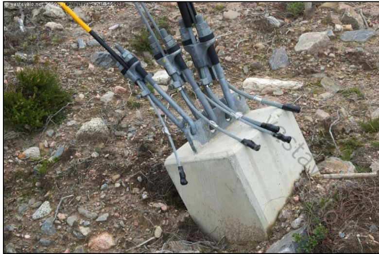
Figura 22. Conexion de 3 cables hacia el pedestal de una fundación. Se puede ver que el cable está conectado a un cabo o estrobo y este a la placa metálica situada en el pedestal. ( https://www.vastavalo.net/isoneva-pomarkku-isoneva-pomarkku-tukivaijerien-ankkurointi-maahan-505928.html ).
