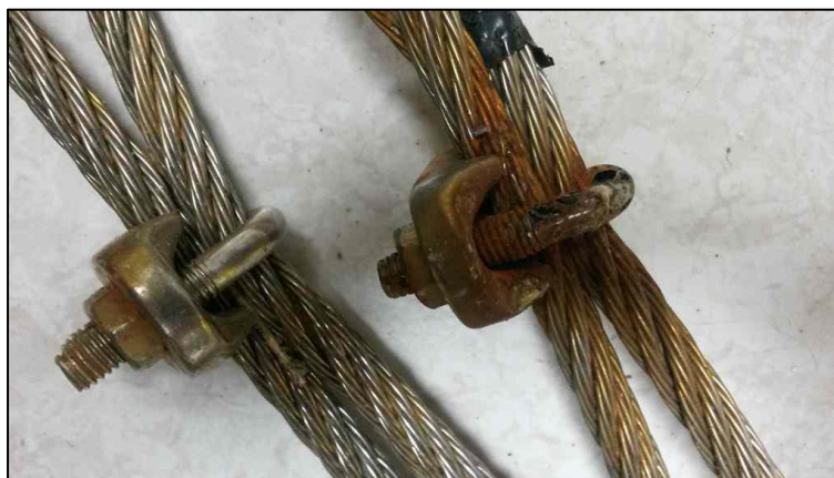
Figura 19. Corrosión situada en la conexión y fijación de 2 cables debido a la pérdida de protección. ( http://www2.ceab.csic.es/oceans/Web/News/2014_09_26.html ).
