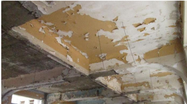
Figura. 35 Daños losa tercer piso
