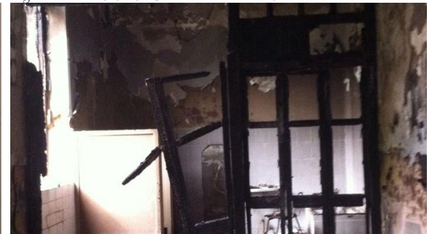
Figura. 43 Daños por incendios en primer piso
