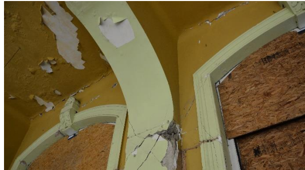
Figura. 36 Daños en unión de vigas con muro
