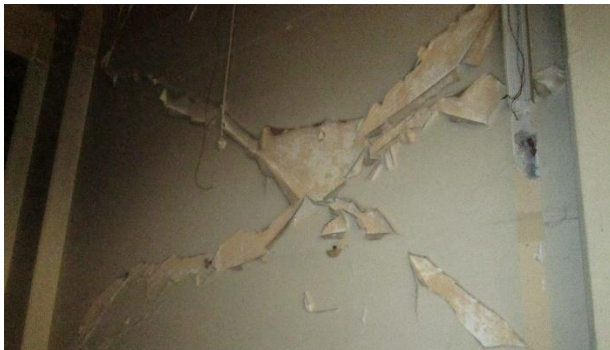
Figura. 38 Ejemplo de grietas en x con perdidas de estuco
