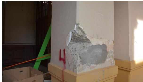
Figura. 39 Perdida de material en pilar
