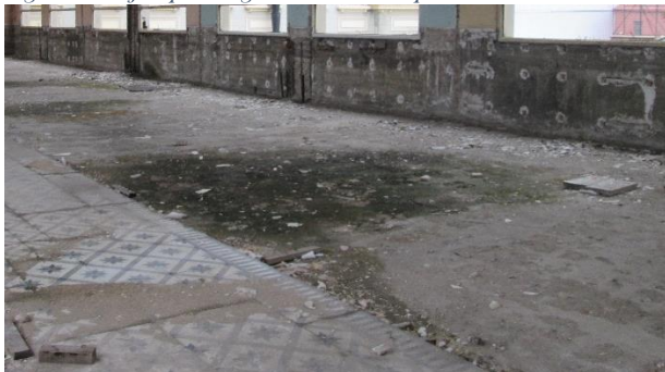
Figura. 41 Daños en pisos tercer piso
