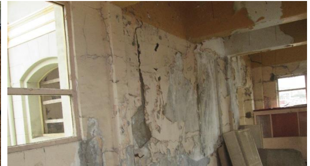
Figura. 37 Daños muro tercer piso
