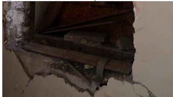
Figura. 42 Daños en vanos de ventanas
