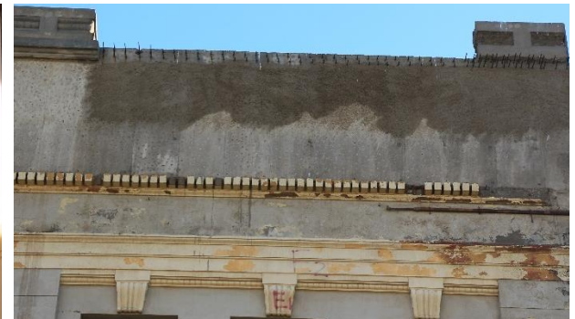
Figura. 40 Perdida de Cornisa en fachada
