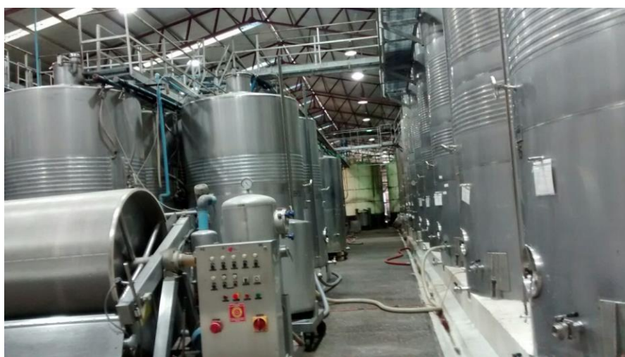
Tanques de acero inoxidable
