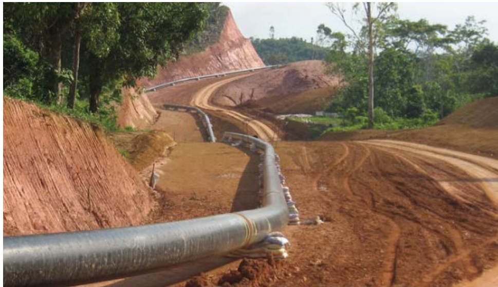
Figura 5: Concentraducto de concentrado de hierro. (Fuente: Ausenco)
