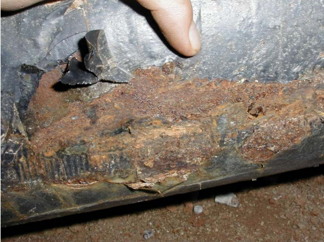
Figura 8: Corrosión externa. (Fuente: Procainsa.com)
