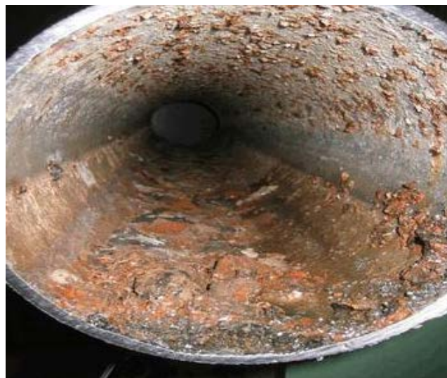
Figura 7: Corrosión interna en cañerías. (Fuente: (Universidad de Santiago de Chile, s.f.))
