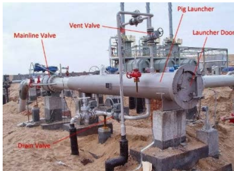
Figura 13: Pig Launcher/Receiver. (Fuente: Metroforensics)
