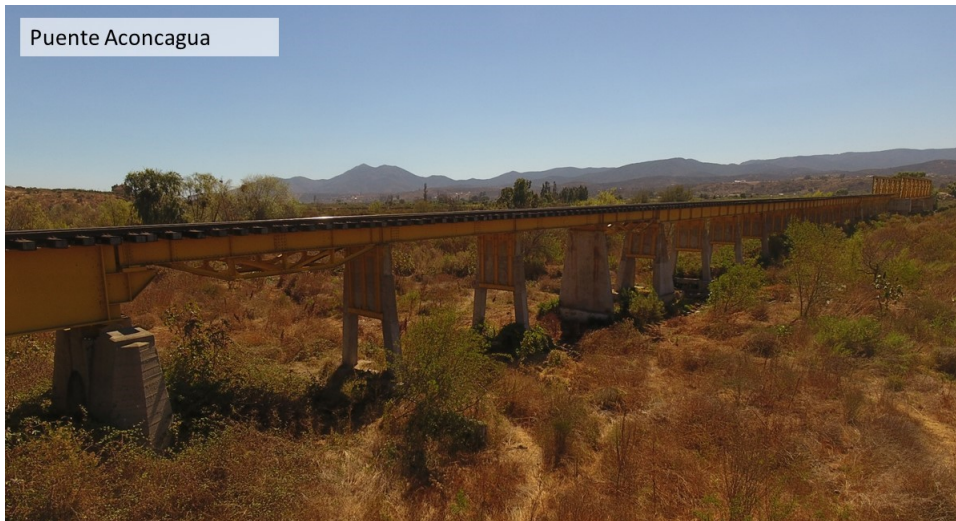
Figura 1.1: Vista general del Puente Aconcagua. Es posible apreciar distintas configuraciones en sus estructuras a lo largo del puente.
