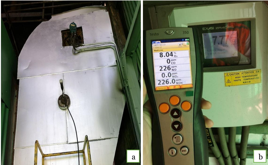
Figura 14: (a) Toma de muestra con analizador de humos y (b) Monitor de analizador de humos.
