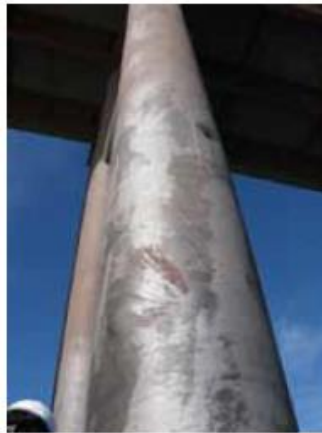
Ilustración 4-18: Fotografía cepa del puente CRSH impactada con escombros del Río Maule.
