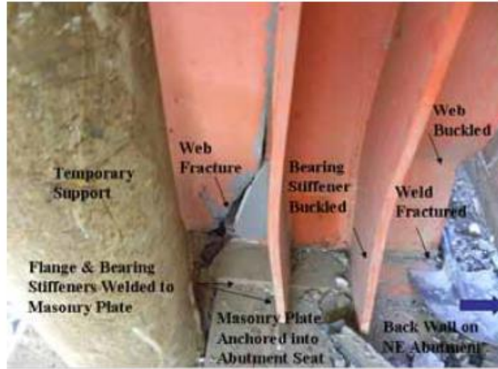
Ilustración 4-15: Fotografía del daño de la viga en el estribo noreste del puente CRSH.
