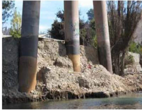
Ilustración 4-17: Fotografía de la erosión del suelo alrededor de las cepas del puente CRSH.
