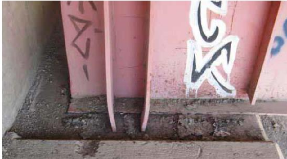
Ilustración 4-19: Fotografía de la soldadura de filete en la conexión de la viga al estribo del puente CRSH.
