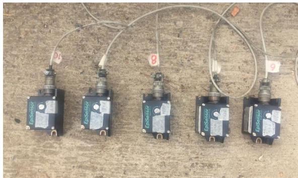
Ilustración 5-14: Registro de calibración sensores instalados viaducto Marga-Marga.
