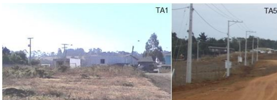
Figura 7. Postes y cables eléctricos en los puntos TA1 y TA6.
