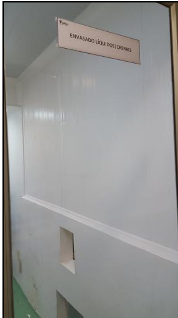
Figura 9: Sala de envasado
