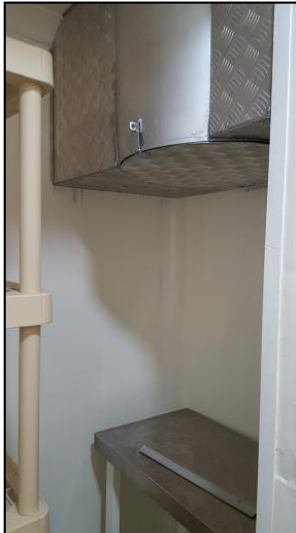
Figura 16: Ducto bajada de envases
