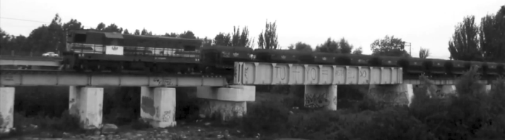
Situación actual tren CAP Mina El Romeral en su paso por el puente férreo del río Elqui Fuente: Elaboración propia.
