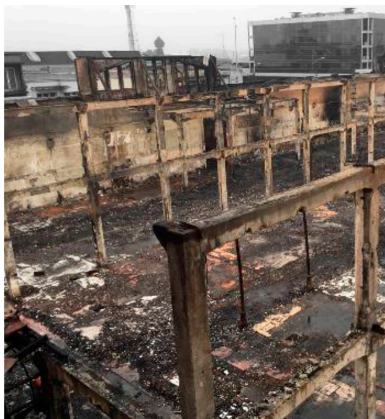
Figura 30. Marcos de Hormigón, fotos desde calle Diego Portales Fuente: Informe IDIEM
