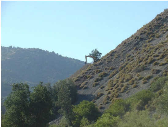
Fotografía 1. Remociones de laderas para construir caminos mineros, sobre la confluencia de los estero El Zaino y la Laja, en el Cajón El Zaino, año 2005. Fuente: Corporación Ciem Aconcagua.
