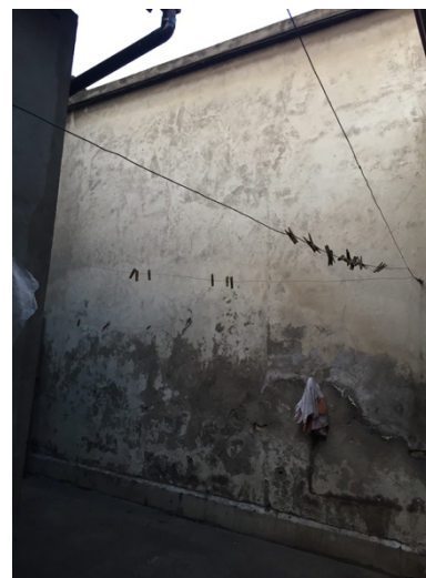
Muro medianero posterior con daños por humedad Fotografía de la autora, 2017.
