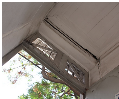
Grieta en muro de fachada con cielo de madera en hall de acceso – Madrid 968 Fotografía de la autora, 2019.
