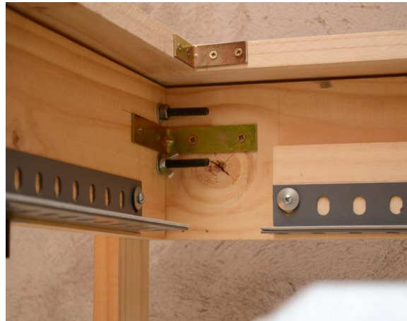
Fig. 173 —Detalle de terminaciones. Perfiles y pernos para el soporte de la pantalla.
