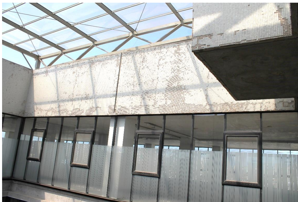
Imagen 67 Convivencia material: restos de mosaicos vítreos originales con las nuevas ventanas con marco metálico y un tragaluz. Registro personal, marzo 2017
