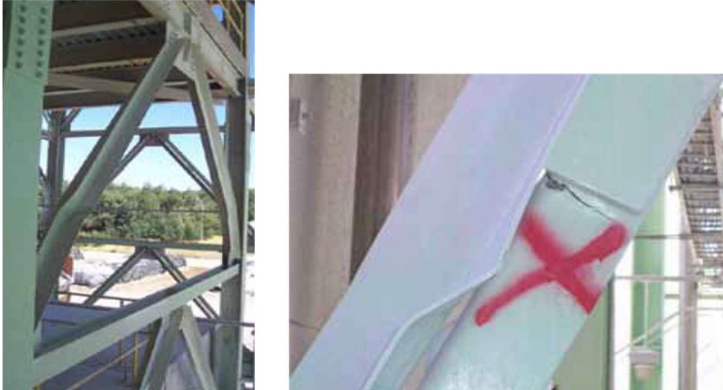
Figura 1.2. Pandeo en diagonales. Global debido a pandeo local (izquierda) y pandeo local del ala (derecha).
