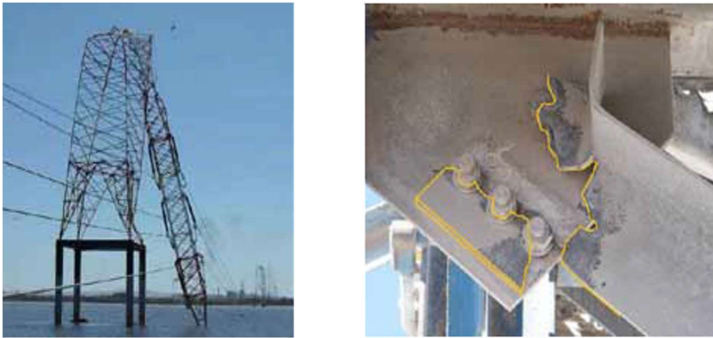
Figura 1.1. (Izq.) Daño en equipo de transmisión. (Der.) Falla de conexión por arrancamiento del bloque de corte. [1]
