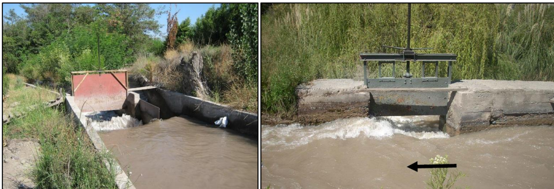
Figura 3-3: Ejemplo de obra de derivación, ubicada en el Río Aconcagua. A la izquierda se muestra un marco partidor y a la derecha una compuerta lateral.
