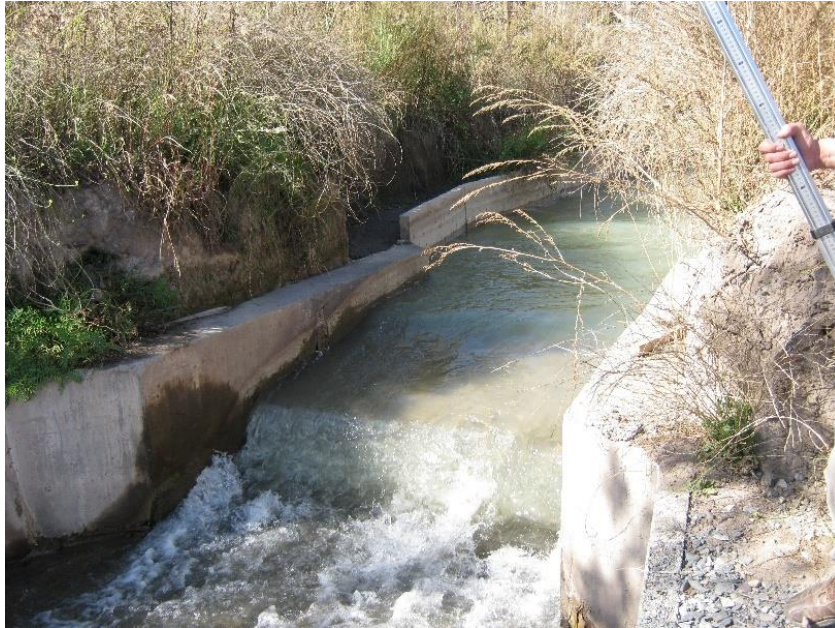
Figura 3-5: Fotografía de una sección de aforo. El método de medición de caudal en esta sección se realiza a través de imponer un régimen crítico en el canal
