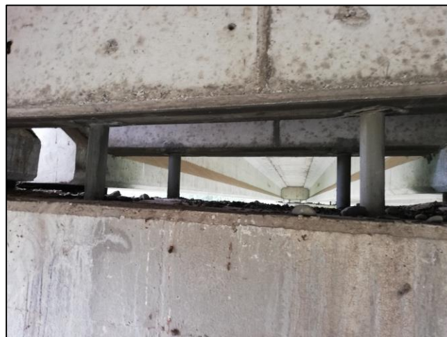
Figura 2-9 Barra antisísmica puente Águila Norte
