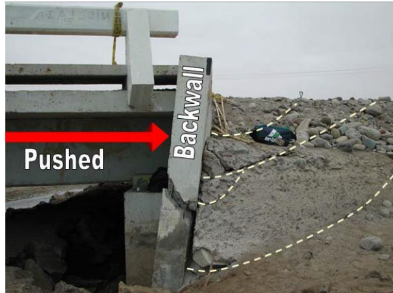
Figura 2-12: Falla estribo movilizando la presión pasiva de suelo (Shamsabadi, 2007)
