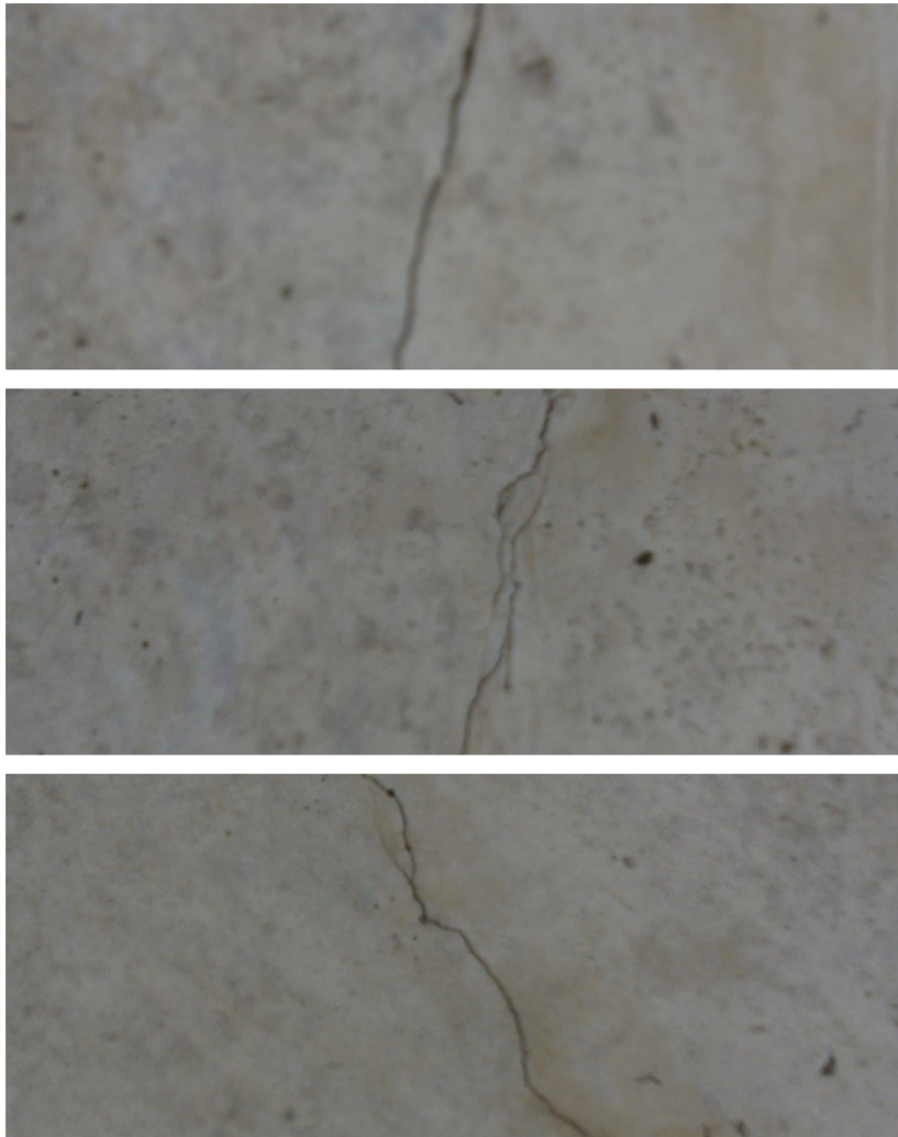
Figura 4.1: Ejemplos de grieta real
