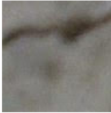
Figura 5.12: Imágen de ejemplo 2 de grieta real.
