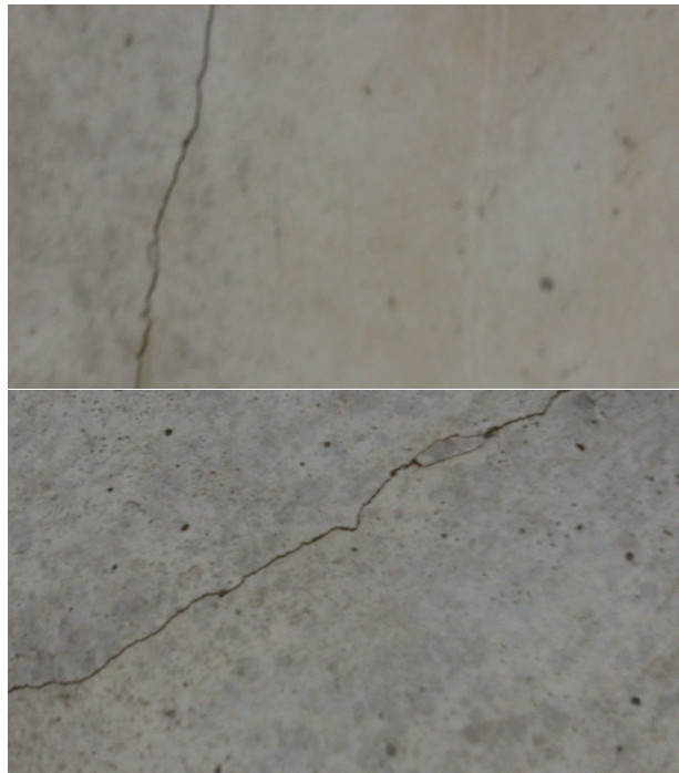
Figura 4.1: Imágenes real de grietas del dataset
