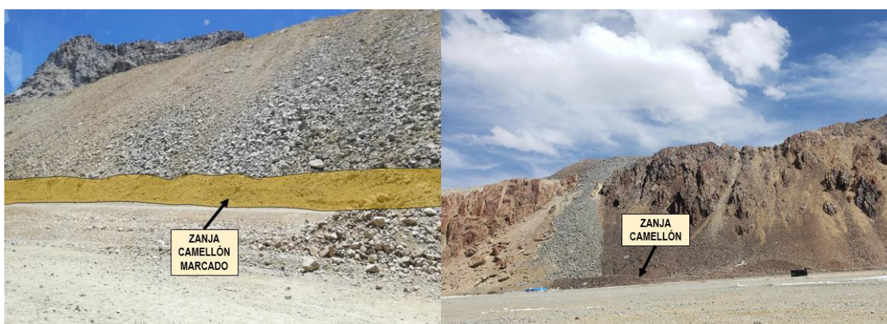
Figura 44: Ejecución Zanja Camellón como requerimiento para futuros trabajos eléctricos. Fuente: Capturas propias.
