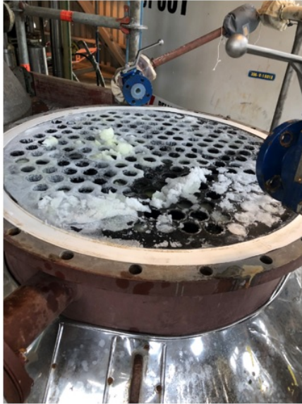
Figura 1.2: Reboiler con tubos tapados [19]
