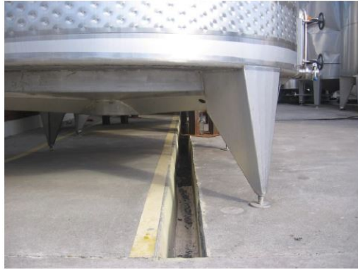
Figura 2.13: Deslizamiento de estanque. [11]
