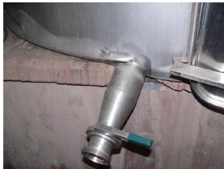
Figura 2.20: Falla de válvula. [11]
