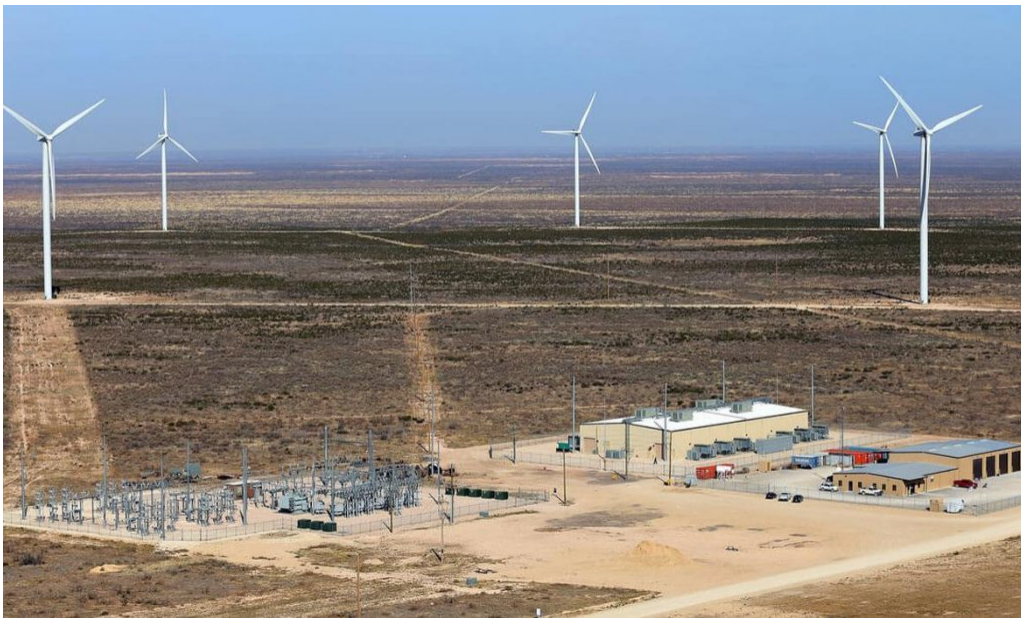
Figura 3.10: Sistema BESS de Ion-Litio junto a central eólica Notrees en ERCOT [80].
