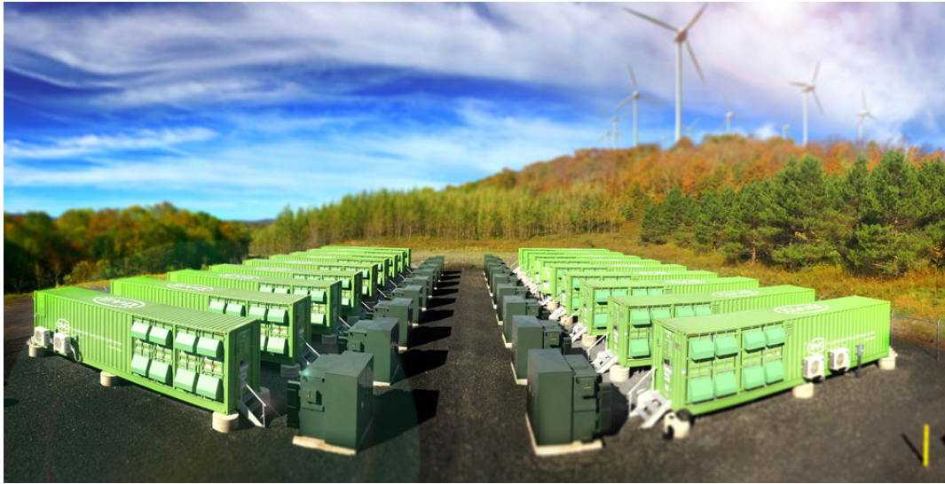
Figura 3.9: Sistema BESS de Ion-Litio Gran Ridge Energy Storage en PJM [76].
