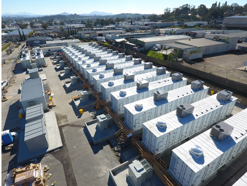
Figura 3.8: BESS Ion-Litio proyecto Escondido en CAISO, cortesía de San Diego Gas & Electric.
