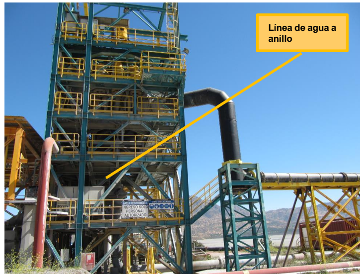
Fotografía 5-14: Tubería de Agua de Alimentación al Anillo de Reciclones
