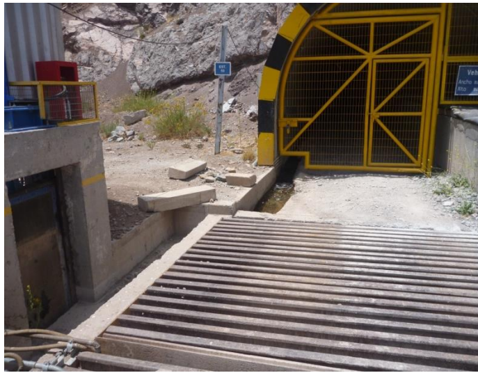
Fotografía 3-8: Compuerta en Portal Salida Túnel N°2
