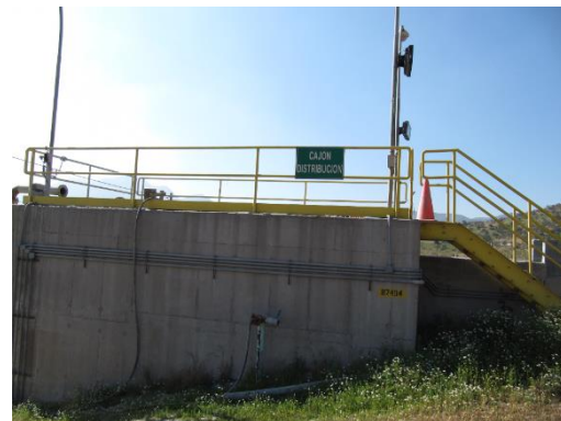
Manguera agua de lavado en cajón de distribución
