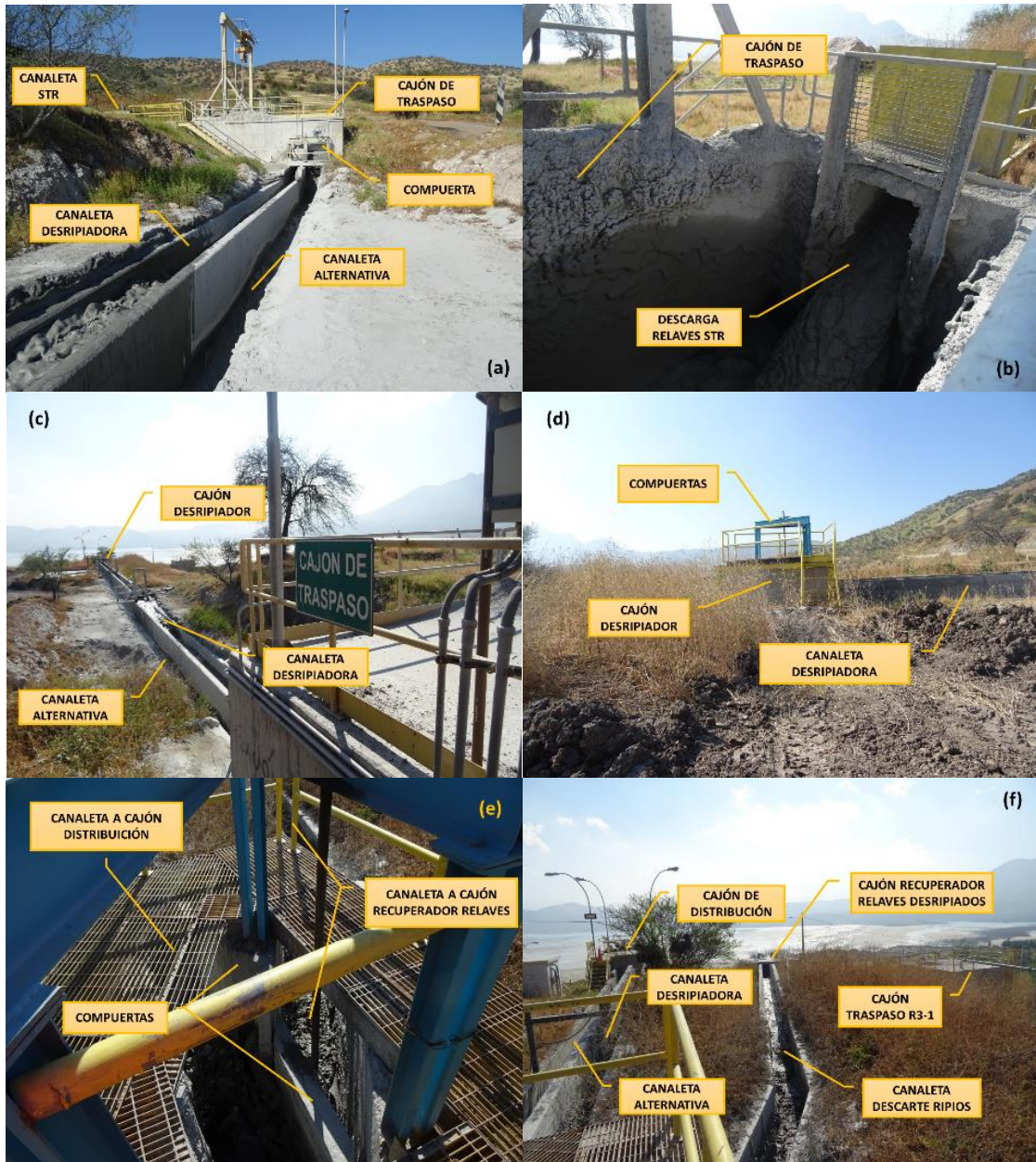
Fotografía 4-1: Instalaciones Sistema de Distribución Relaves
