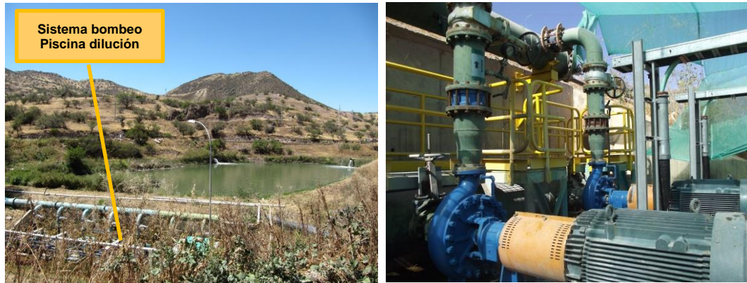
Fotografía 5-9: Sistema de Bombeo Piscina de Agua de Dilución
