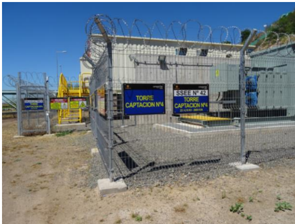
Sala Eléctrica Torre de Captación
