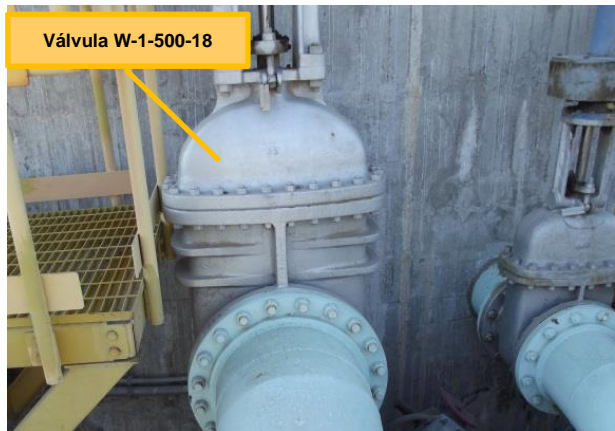
Válvula de accionamiento manual ubicada a la salida del Estanque de Dilución y Lavado
