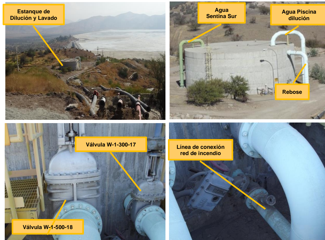
Fotografía 5-10: Estanque de Agua de Dilución y Lavado y Válvulas
