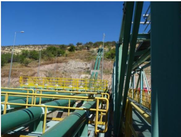
Líneas de Agua recuperada hacia Canal de contorno
