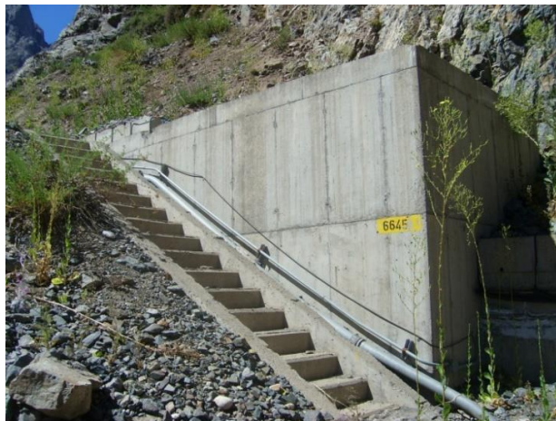
Fotografía 3-3: Cajón de Caída
