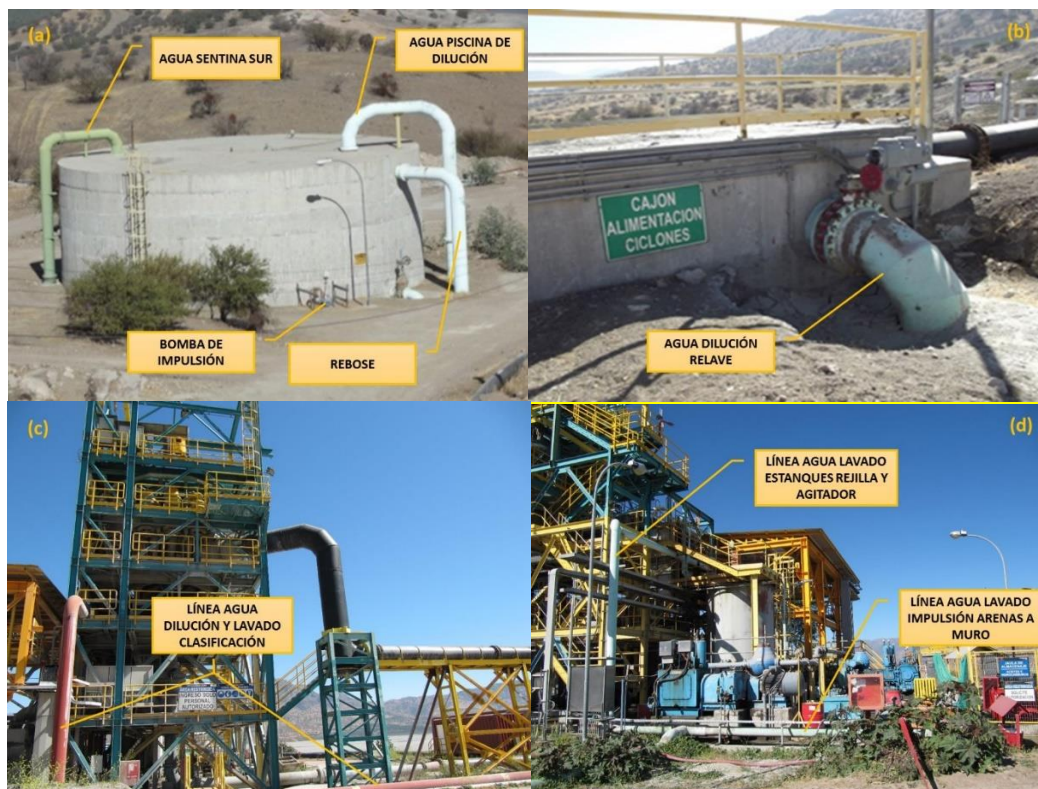
Fotografía 4-8: Sistema de Agua de Dilución y Lavado
