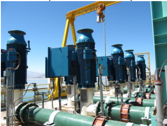
Bombas de Agua Recuperada
