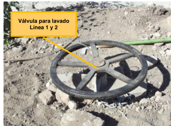
Válvula de accionamiento manual ubicada previo a su conexión con la Línea 1 y 2
