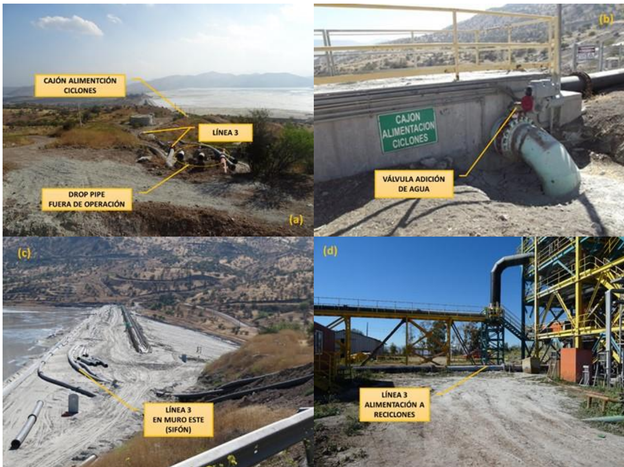
Fotografía 4-3: Sistema de Conducción de Relaves a Clasificación (Línea 3)
