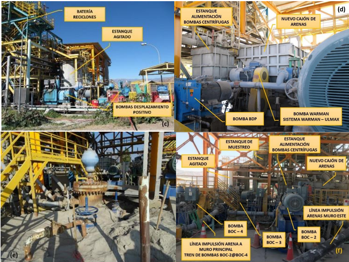
Descripción: (a) y (b) Estanque agitado. (c) Bombas de desplazamiento positivo BDP. (d) Ubicación Estanque alimentación bombas centrífugas BC, cajón de arenas y bombas. (e) Chimbombo. (f) Bombas centrífugas tren de bombas BOC – 002 @ BOC – 004.
