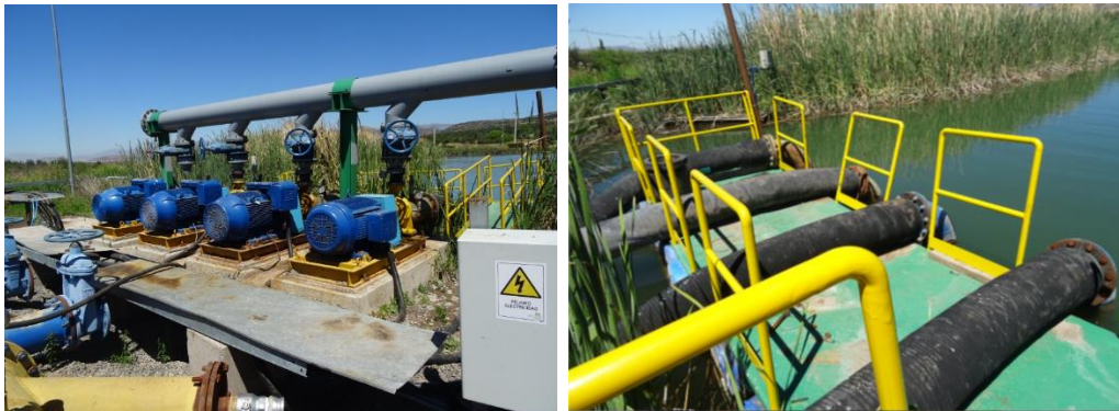
Fotografía 5-4: Bombas de agua en Tranque de acumulación Nocturna (TAN)
