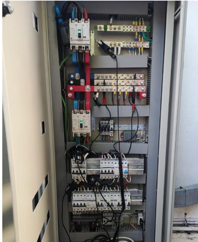
Figura 2.4: Imagen del sistema de monitoreo en tablero eléctrico de la AgenciaSE
