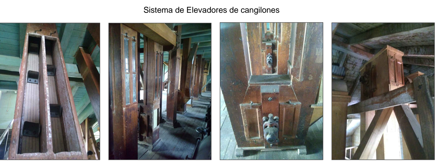
Sistema de Elevadores de cangilones Elevadores de cangilones, en piso 2 tiene área de inspección es una cubierta lateral removible de vidrio Comunicador, esta presente en los extremos de inicio y fin de los elevadores piso 1- piso 2 - piso 5
