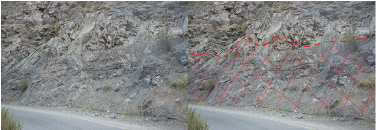
Figura 55: Talud fortificado parcialmente. Todo el tramo superior queda expuesto.
