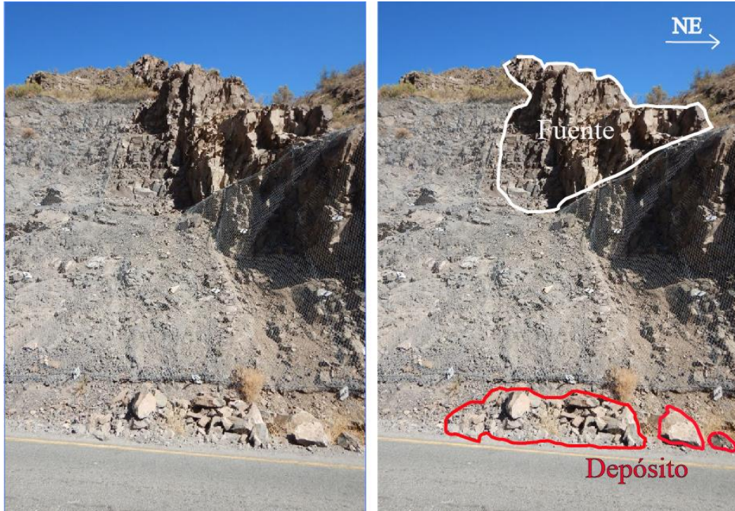
Figura 36: Acumulación de bloques a orillas del camino en el kilómetro 49 aproximadamente (CoorE:380816; CoorN:6265384; WGS 84 Zona 19S).
