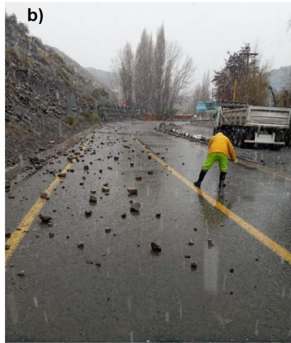
Figura 74: Caídas de rocas registradas (a) el día 12 de junio en el sector de Los Almendros y (b) el 29 de junio en el Puente El Yeso. Fuente: @mop_rm, Twitter Oficial de la Secretaría Regional Ministerial de Obras Públicas.
