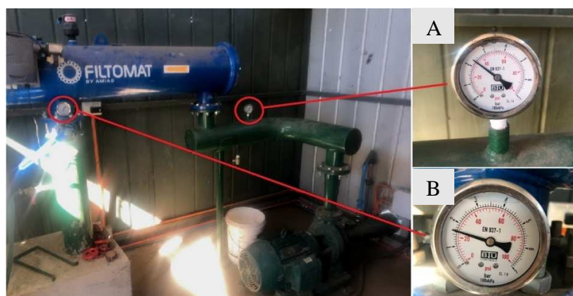
Figura 2. Disposición de manómetros en la estación de filtrado. En (A), manómetro aguas arriba, presión de 2,3 bares; en (B), manómetro aguas abajo, presión de 1,7 bares. El momento de realizar la limpieza de los filtros es cuando el diferencial de presión entre ambos manómetros supera los 5 m.c.a (0,5 bares). En la figura el diferencial llega a los 0,7 bares, cometiéndose el error de trabajar con el filtro sucio.
