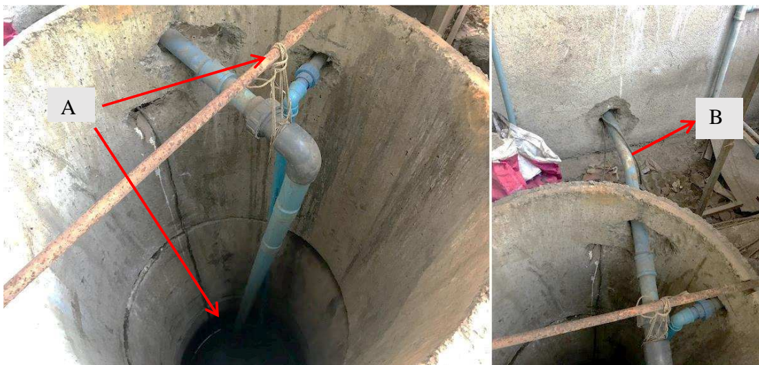
Figura 4. Tubería de succión en noria. (A) soporte inadecuado que provoca una inclinación excesiva hacia la fuente de agua succionando el agua desde el borde del espejo de agua
