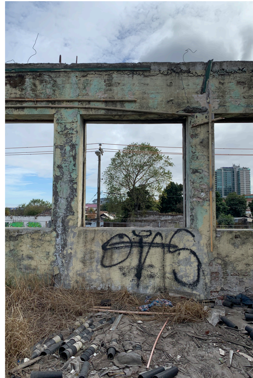
FIGURA 9 Diferencias técnicas constructivas en los vanos del inmueble fuente Elaboración Propia
