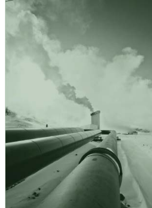
Fig.14 Planta geotérmica Hellisheiði Fuente: www.geothermalcommunities.eu
