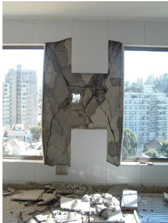
Figura 3.29: Falla de machón por corte vista desde el interior de un departamento (Leiva et al., 2010).
