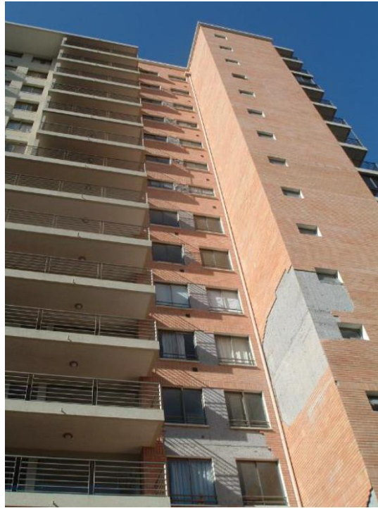
Figura 3.28: Desprendimiento de revestimiento exterior de machones en fachada norte (Leiva et al., 2010).
