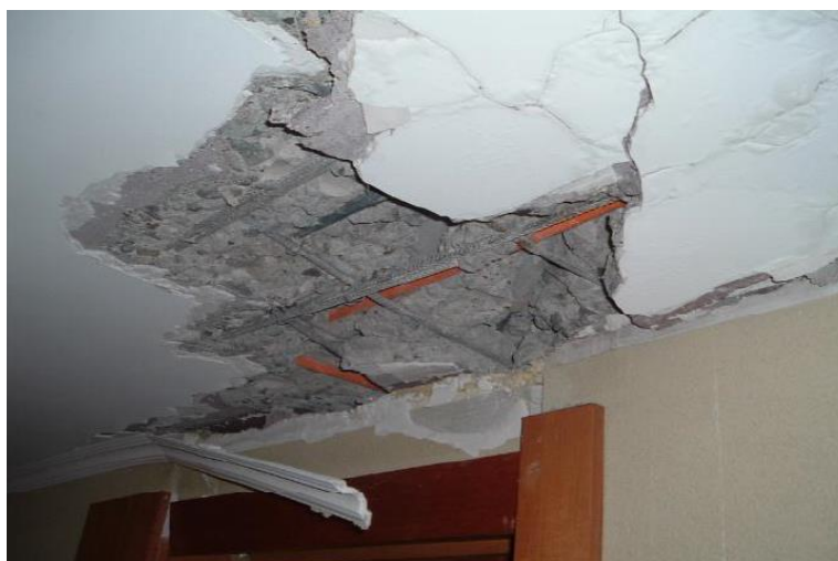
Figura 3.26: Losa agrietada por acoplamiento de estas sobre dinteles de las puertas de acceso a departamentos (Leiva et al., 2010).
