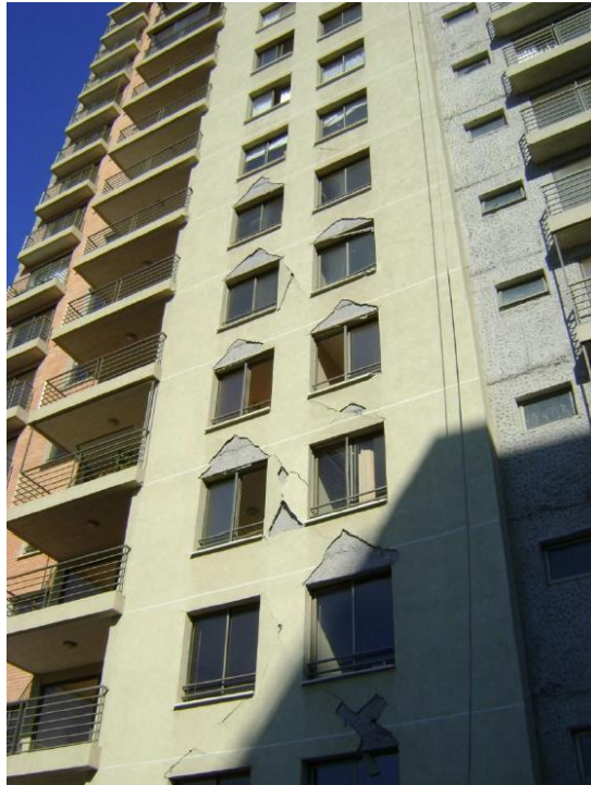
Figura 3.27: Desprendimiento de revestimiento exterior de dinteles en fachada oriente (Leiva et al., 2010).
