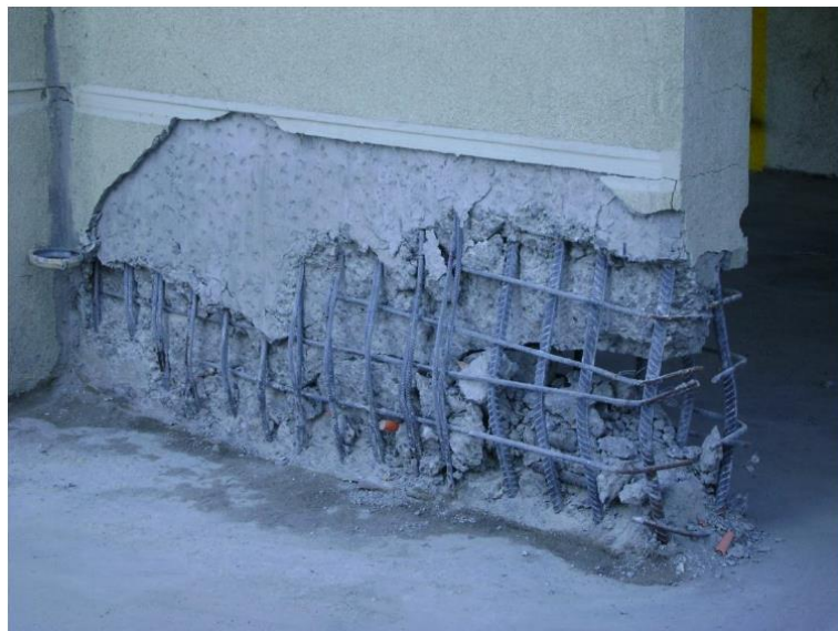
Figura 3.22: Muro estructural dañado de la fachada oriente del primer piso (Leiva et al., 2010)
