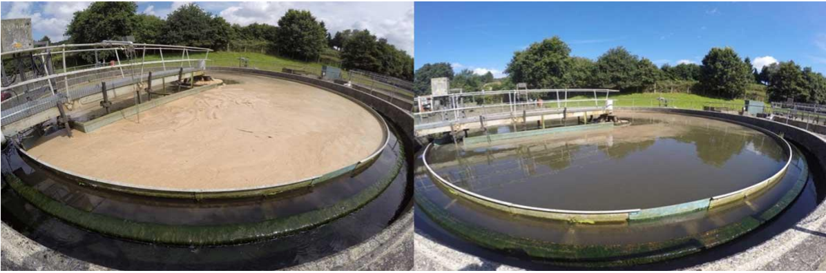
Figura 13: A la izquierda: Clarificador Secundario con problemas de Bulking Filamentoso y Foaming (espumamiento). A la derecha: Clarificador Secundario en condiciones normales [43].
