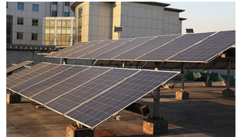
Imagen 13: Paneles fotovoltaicos en cubierta edificio en altura.
