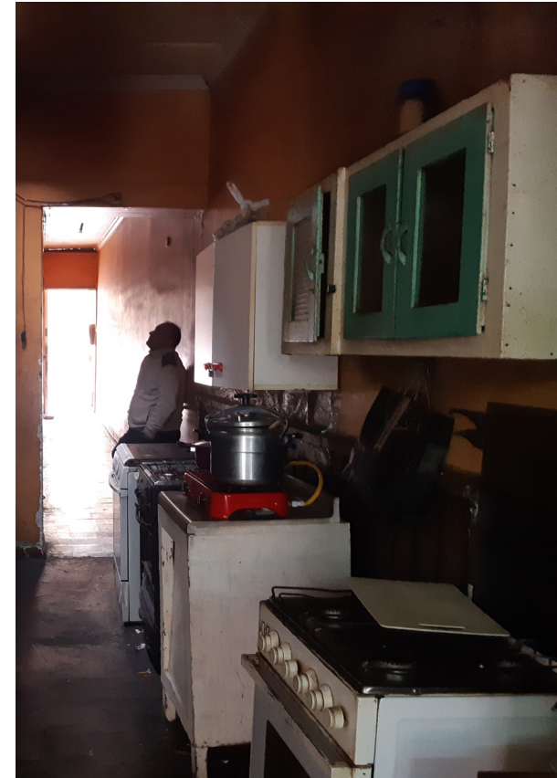
Fig 59: Instalaciones al interior de vivienda colectiva.
