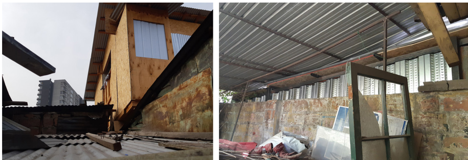
Fig 58: Ampliaciones constructivamente precarias.
