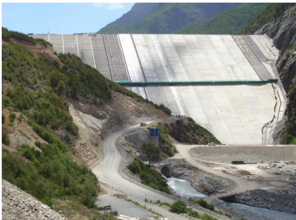
Figura 9: Embalse Ancoa en etapa de construcción Fuente: Página oficial de BESALCO, empresa contratista del embalse Ancoa
