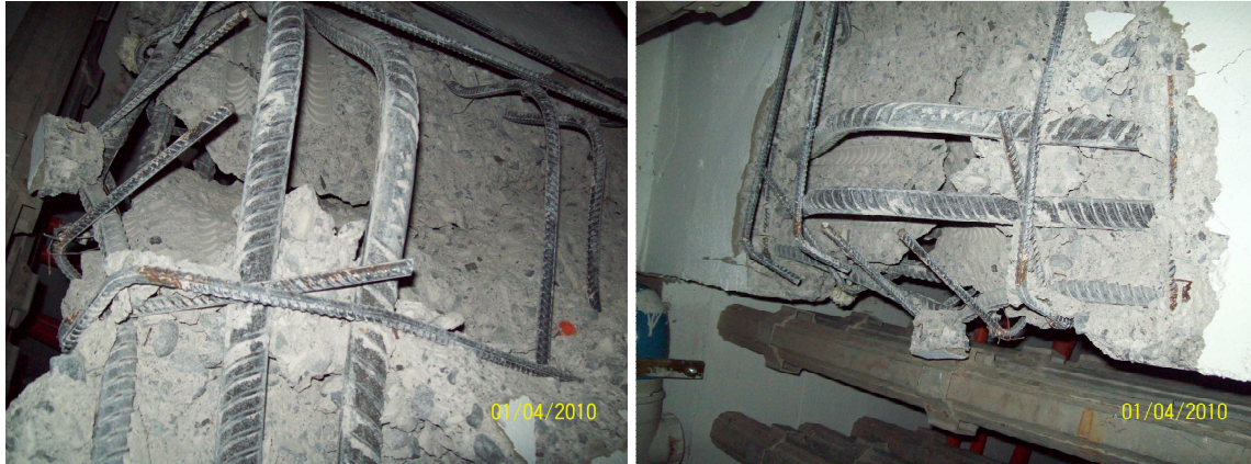
Figura 10: Muro dañado de Emerald con pando de armaduras en el borde del alma.
