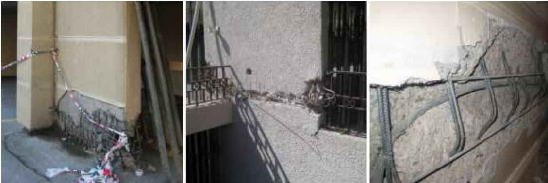
Figura 2: Daños en bordes de muro: pandeo de barras longitudinales y aplastamiento del hormigón [12].
