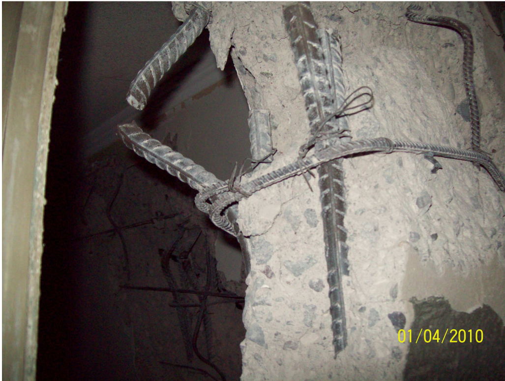
Figura 11: Muro dañado de Emerald con fractura de barras en el borde del alma.
