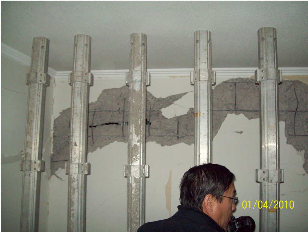
Figura 7: Muro dañado de Emerald con desprendimiento de hormigón de recubrimiento.
