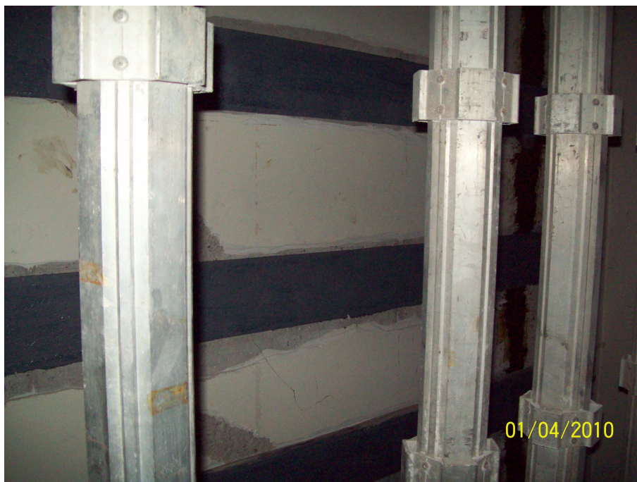
Figura 14: Vista cercana de un muro reparado de Emerald que presenta patrón de grietas diagonales.
