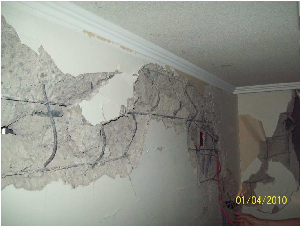
Figura 8: Muro dañado de Emerald con propagación de grietas.
