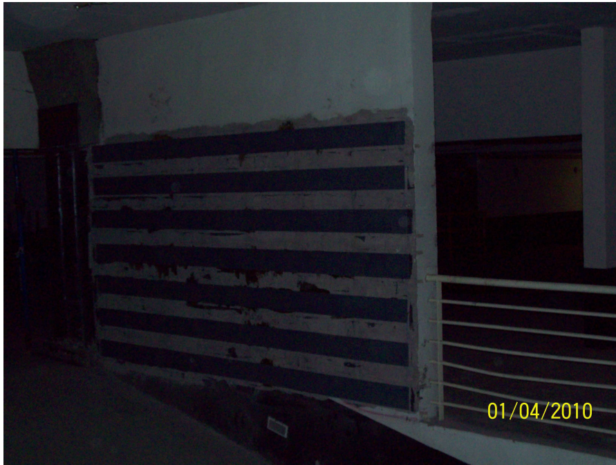
Figura 13: Vista general de un muro reparado de Emerald que presenta patrón de grietas diagonales.
