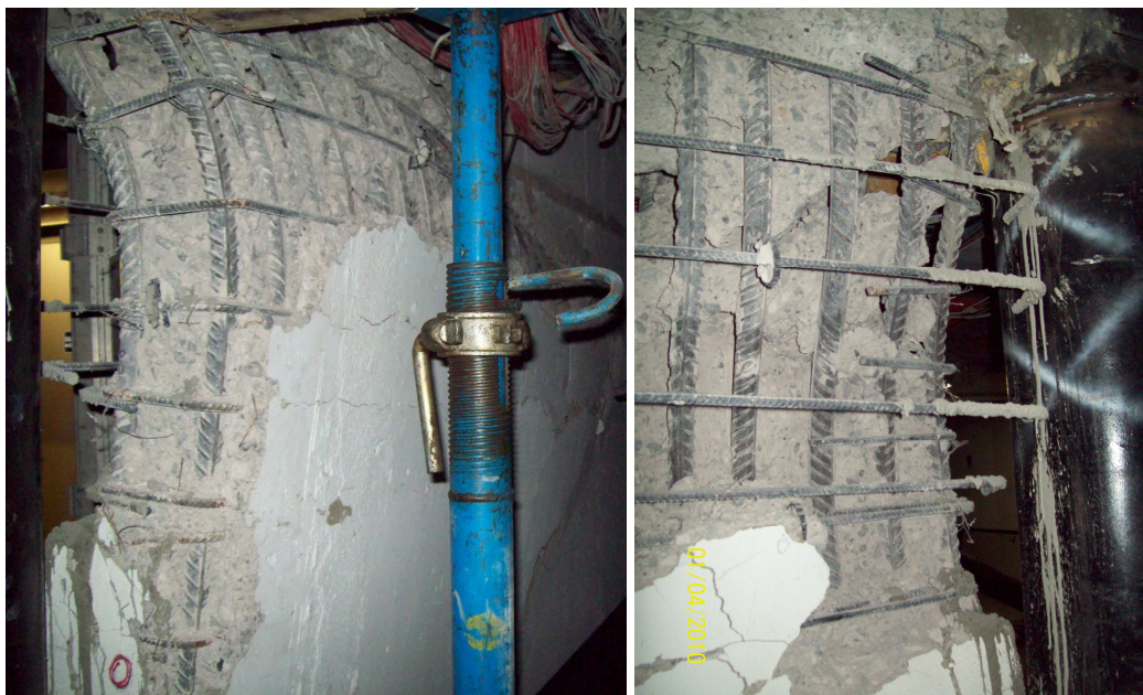
Figura 12: Muro dañado de Emerald con falla de inestabilidad por pandeo global.
