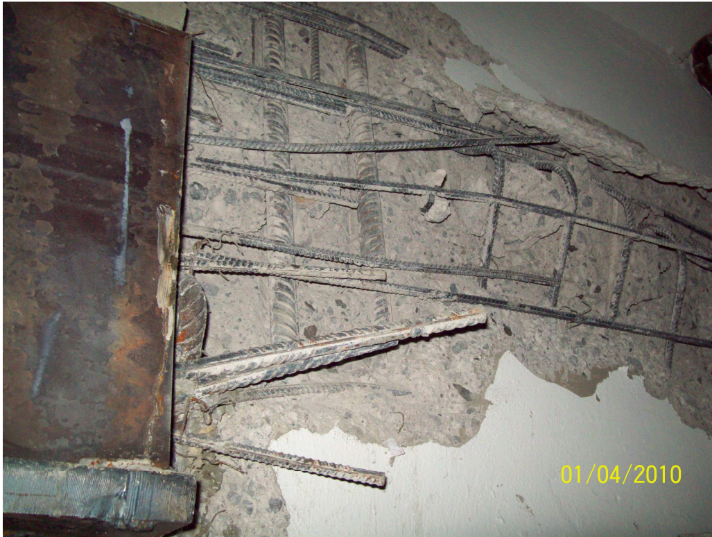
Figura 9: Muro dañado de Emerald con desprendimiento de hormigón y pando de armaduras.
