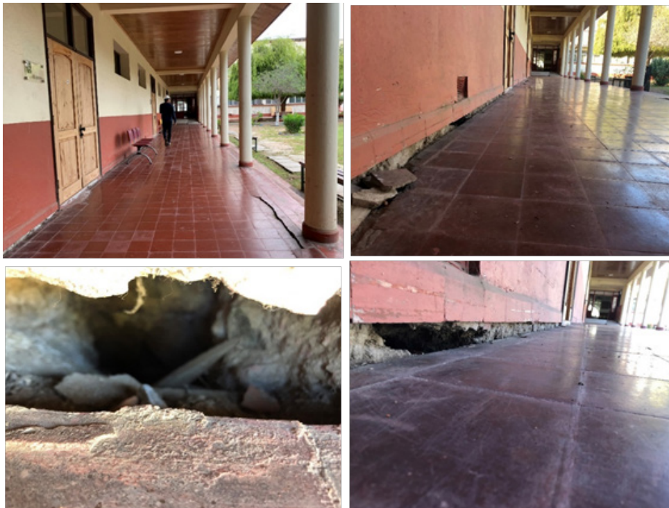
Figura 89: Asentamiento observado en terreno en elementos verticales. Fuente Elaboración propia.
