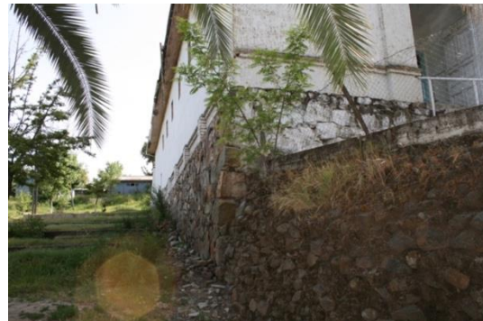
Ilustración 58: Detalle del zócalo de la fachada poniente, octubre 2008.
