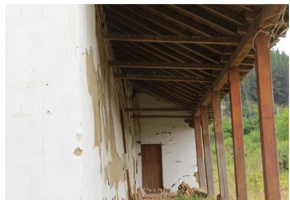
Ilustración 165: Detalle del estado del corredor, año 2019. Fuente: Ibidem.
