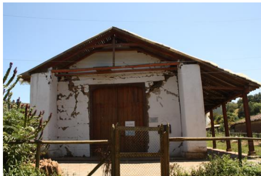
Ilustración 148: Vista de la fachada principal, año 2010, posterior a terremoto 27 febrero. Fuente: Ibidem.
