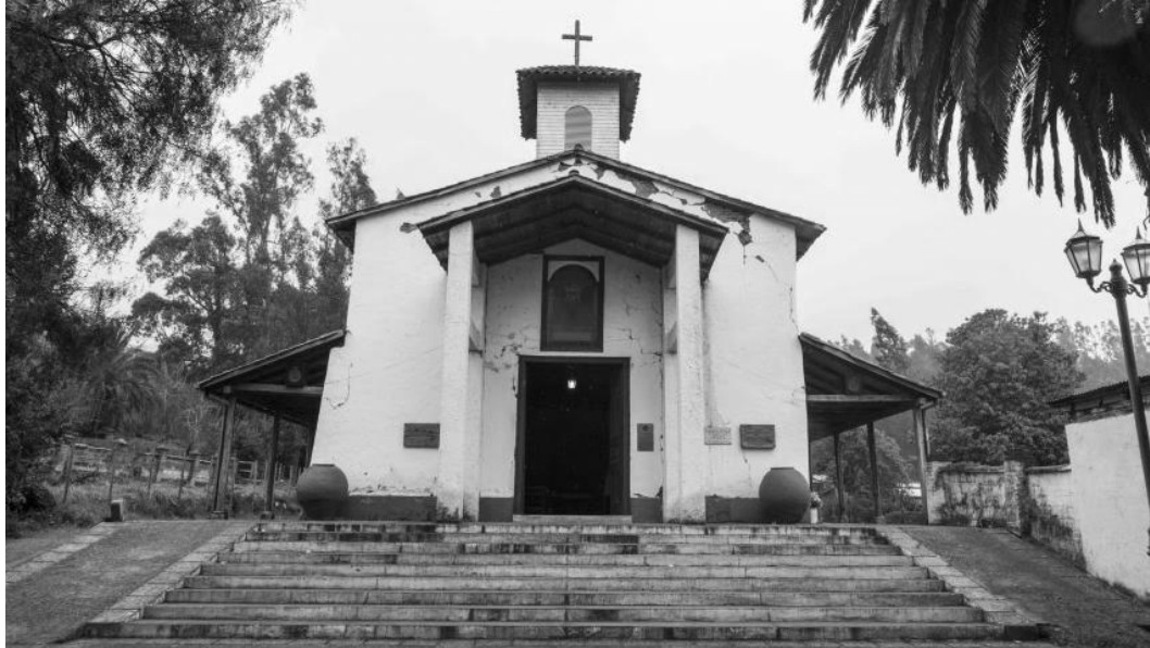
Ilustración 81: Vista general del santuario posterior al terremoto de febrero de 2010. Fuente: https://www.monumentos.gob.cl
