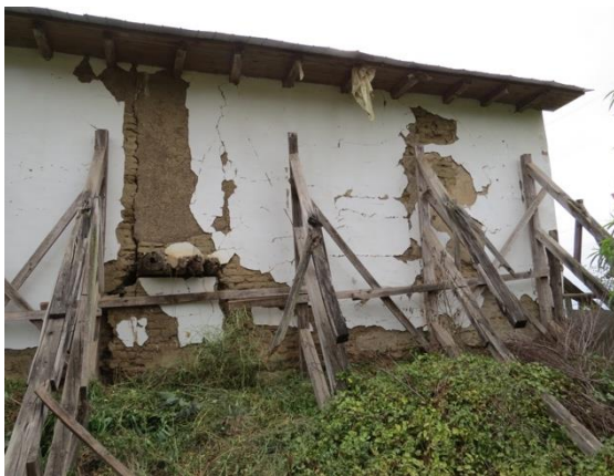
Ilustración 168: Detalle del estado del muro medianero, año 2019. Fuente: Ibidem.
