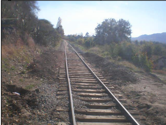
Figura 70: Vía férrea sin reparación
