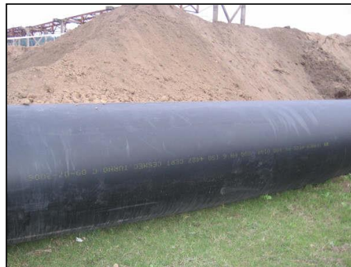
Figura 23: Emisario de desechos industriales
