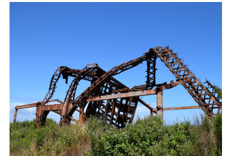
Pique Alberto (derrumbado en el 2017)
