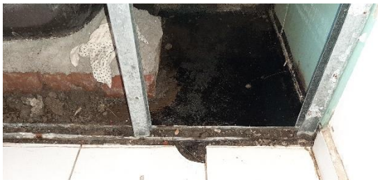
Fig. 94 Imagen: Filtración de agua bajo tina, vivienda caso 1 (Fuente: Elaboración propia)
