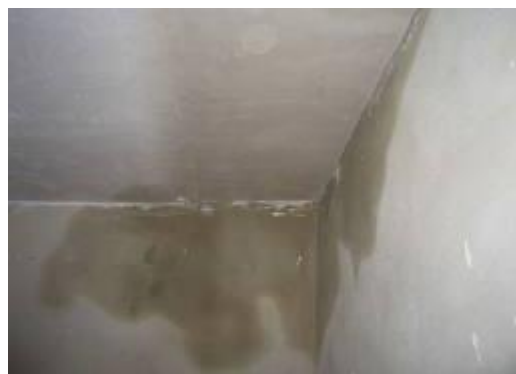
Fig. 172 Imagen: humedad en los departamentos (Fuente: Proporcionada por habitantes)
