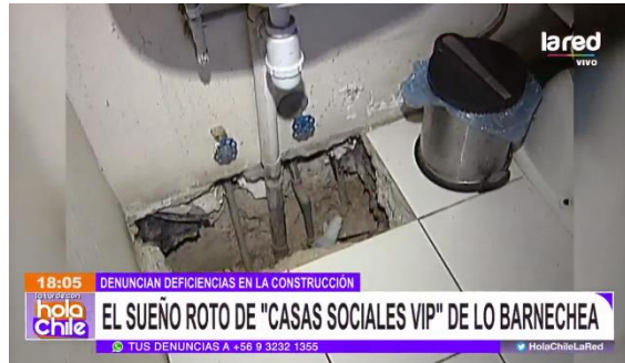
Fig. 93 Imagen: Filtración en viviendas conjunto (Fuente: lared.cl)
