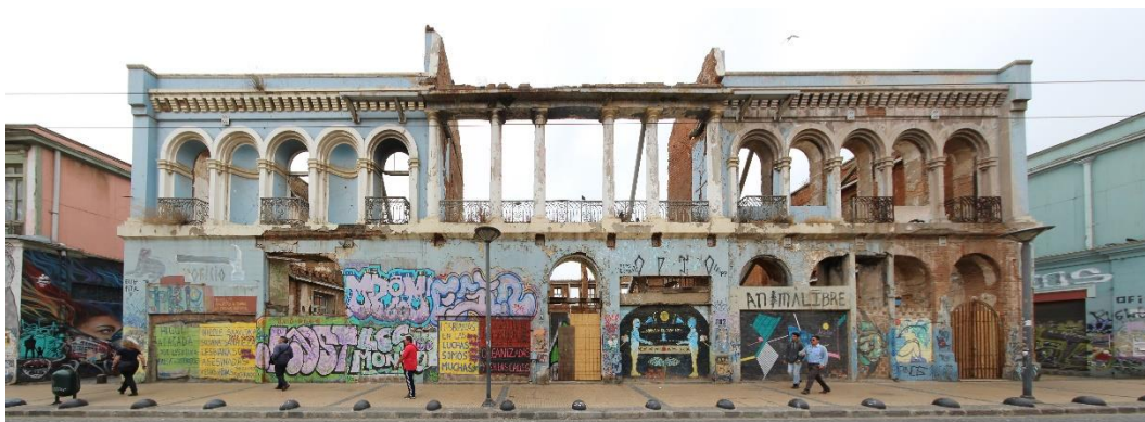
Figura 39 – Estado actual del Palacio Subercaseaux, 11 años después de la explosión. Fecha: 15.02.2018. Autoría propia
