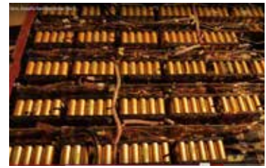
Figura 199: Ejemplo de banco de baterías de auto solar Eolian Fénix
