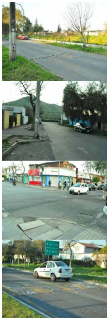
Figura 34 : (en orden descendente) Resalto no reglamentado, Desnivel, Baches y Resalto reductor de velocidad.
