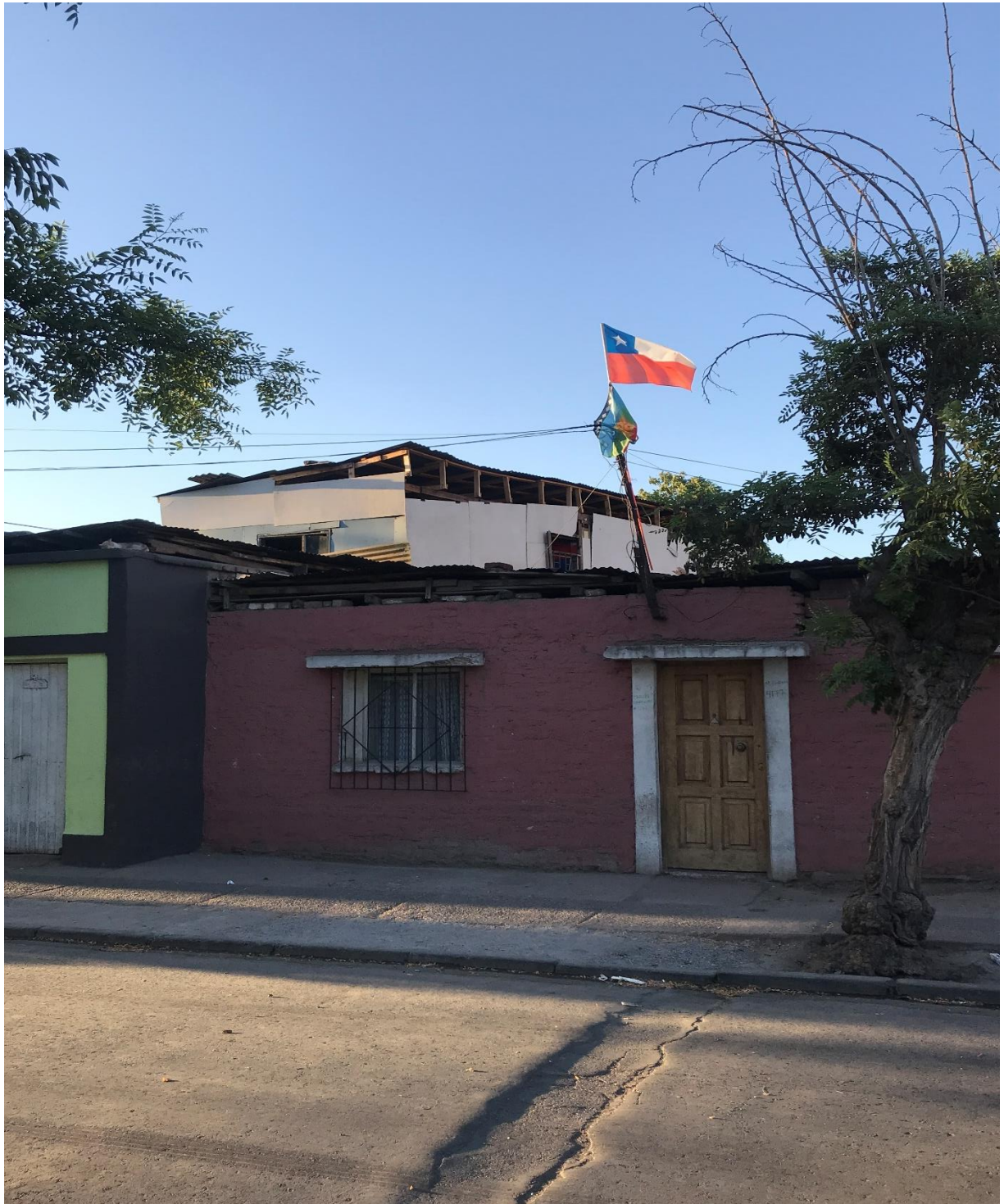
Fotografía 11. Ampliación precaria segundo piso yeso cartón. Fuente: Registro propio
