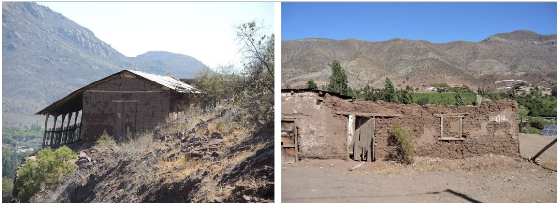
Fig. 4 Viviendas en adobe con daños sísmicos y abandonadas, comuna de Río Hurtado, Región de Coquimbo.
